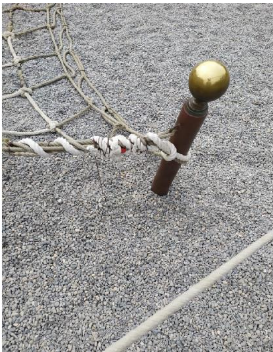
ELEMENTS DETERIORATS O IMPROPIS
